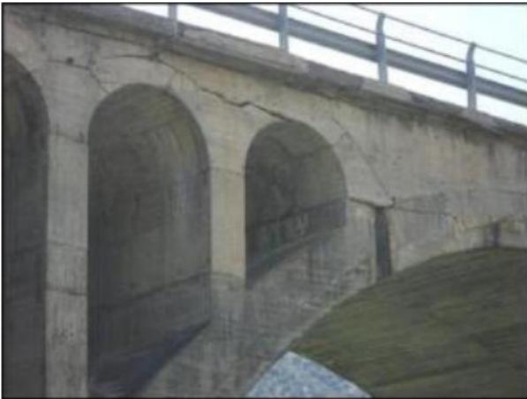
Patologia detectada en la inspecció bàsica
