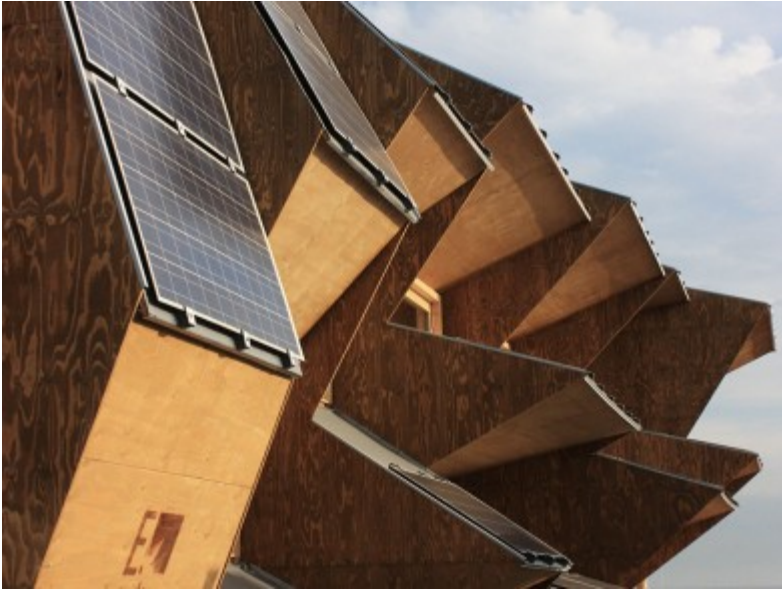
Detall de plaques fotovoltàiques
