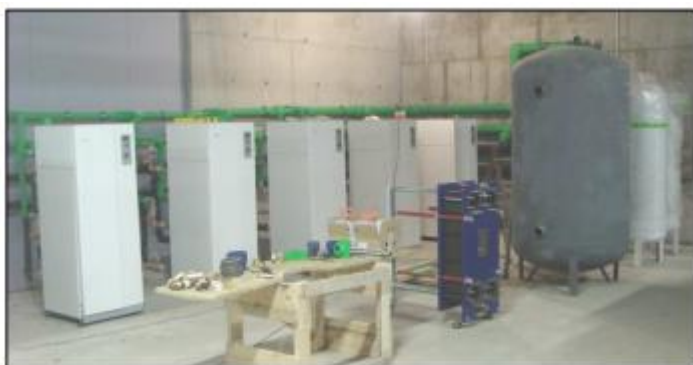
Sala de producció geotèrmica
