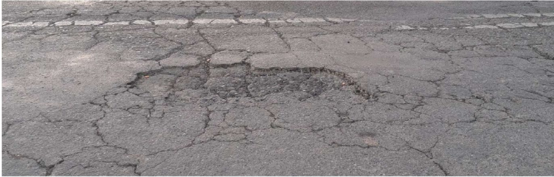
Imatge 4 i 5. Detall de l'estat inicial del ferm
