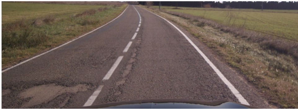
Imatge 5. Peladures d'alta severitat fins a formació de sot (esquerra de la imatge).
