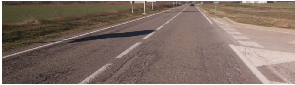
Imatge 4. Peladures i fissuració en pell de cocodril
