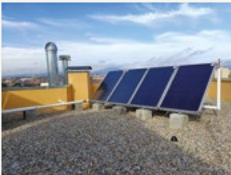
Sistema d'energia fotovoltaica.
