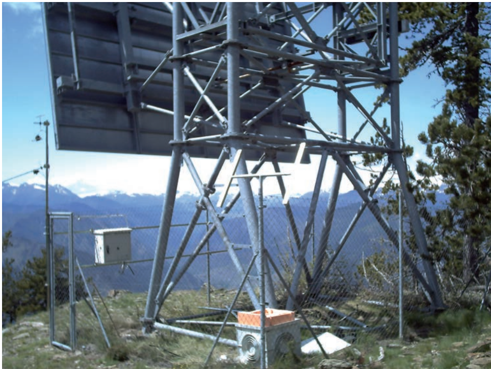
Instal·lacions de Telefònica a Campirme. Jordi Viñas.
