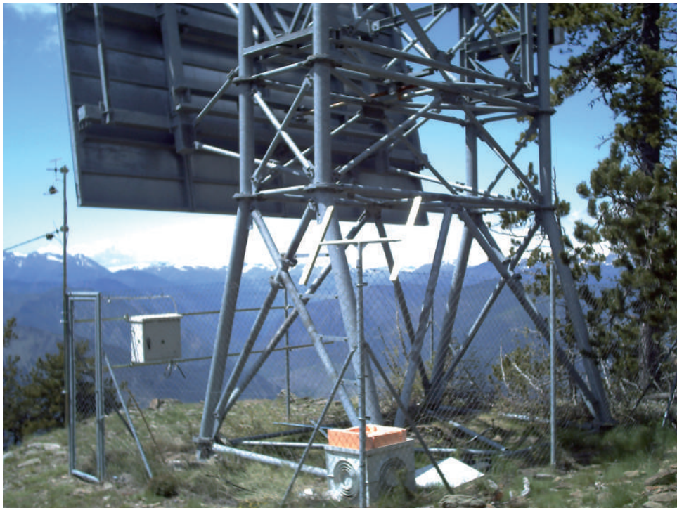
Instal·lacions de Telefònica a Campirme. Jordi Viñas.
