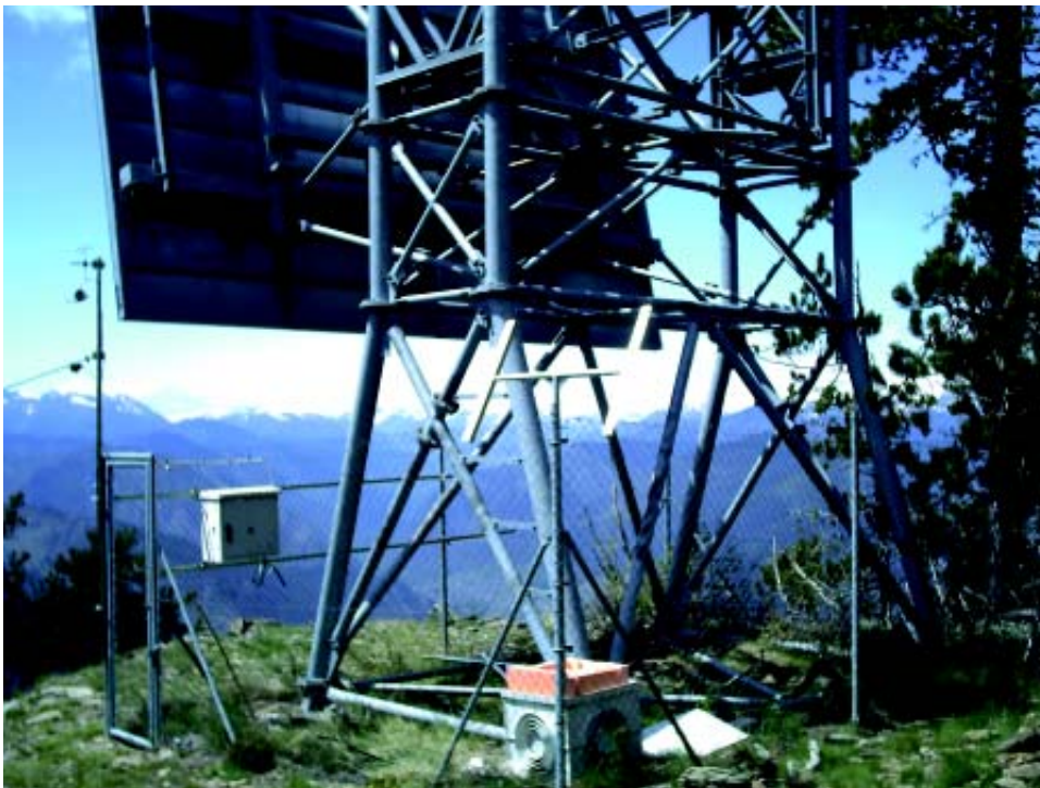
Instal·lacions de Telefònica a Campirme. Jordi Viñas.
