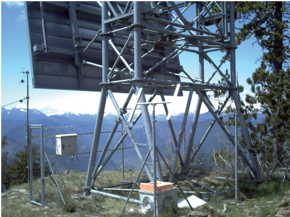
Instal·lacions de Telefònica a Campirme. Jordi Viñas.
