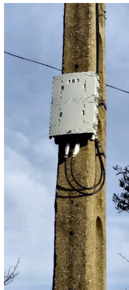
Detall de pal de formigó amb caixa de fibra òptica
