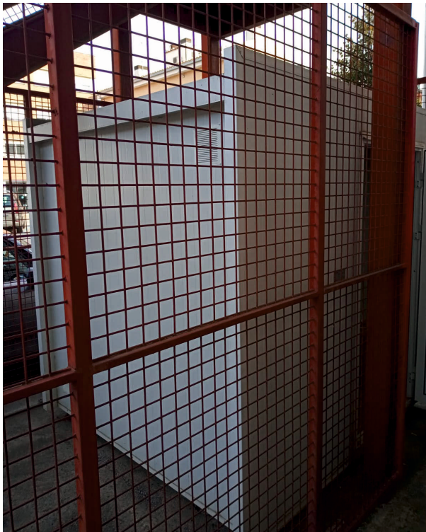
Sala de telecomunicacions en forma de caseta exterior
