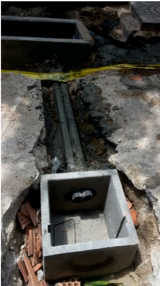
Canalitzacions soterrades entre diversos pericons
