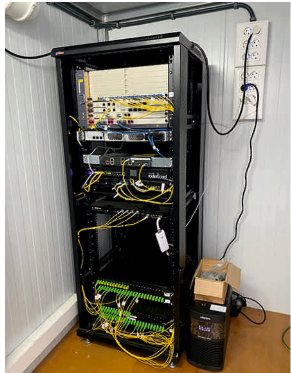
Interior, amb rack de l'OLT i resta d'elements
