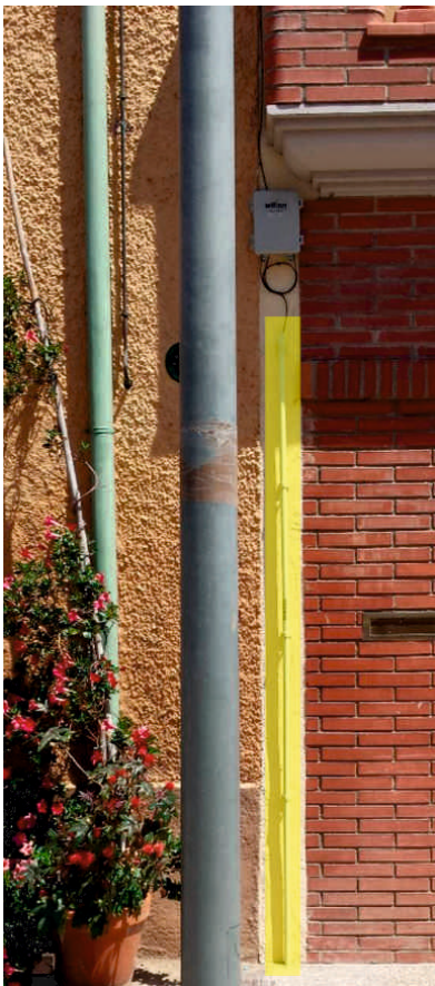
Canalització vertical per façana (marcat en groc)
