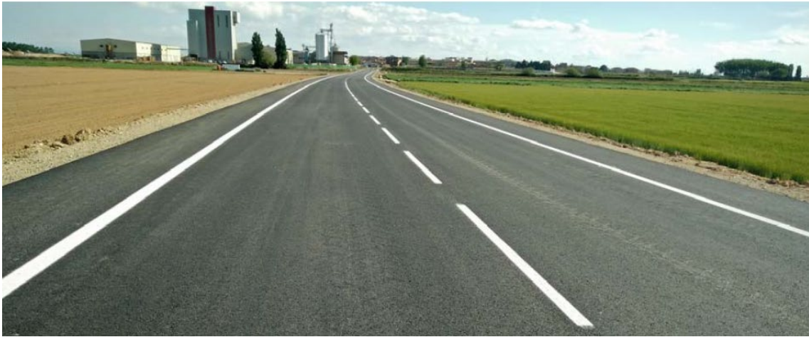
Figura 46. Imatge de l'estat actual de la carretera LP-3222 (Font: Memòria del Departament 2019).
